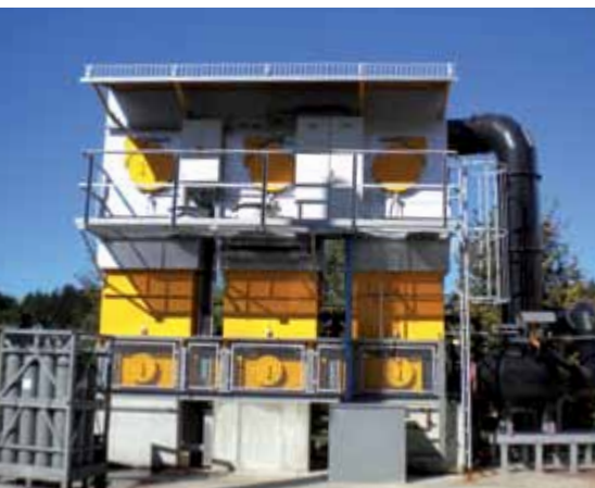
Abb. 13: Abgasnachbehandlungsanlage (hier: RTO) zur Reinigung von Abluftströmen (hier ca. 2.000 m 3 /h) einer Druckwasserwäsche [13]
