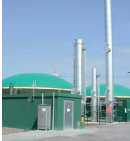
Abb. 1: Beispiel für eine Biogasanlage mit anschließender Aufbereitung zu Biomethan [13]
